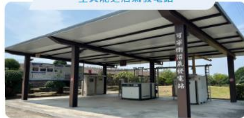
生質能之沼氣發電站
