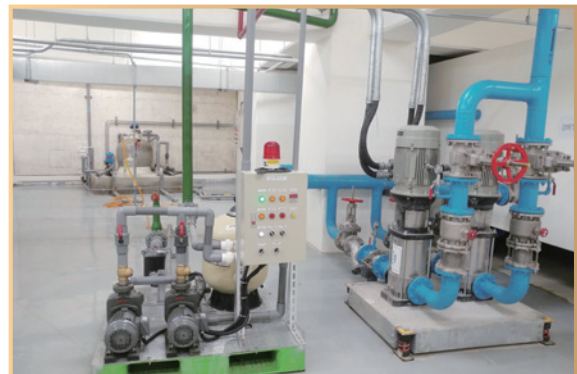
證交所第一資訊中心雨水回收系統，增加水資源利用效率。
