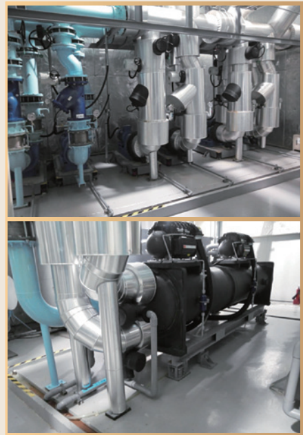
證交所第一資訊中心採用變頻式空調設備，節能又環保。
